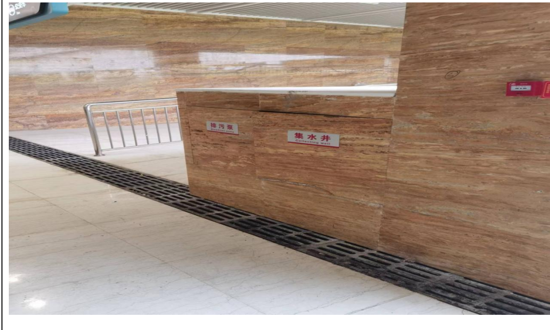
图 2-3 干挂墙面隐藏式供电系统箱
